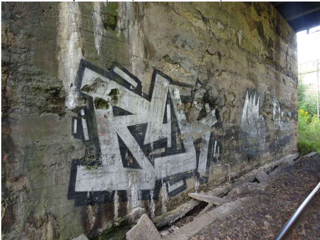
Rys. 1. Przyciótek południowo-wschodni. Ubytki betonu
