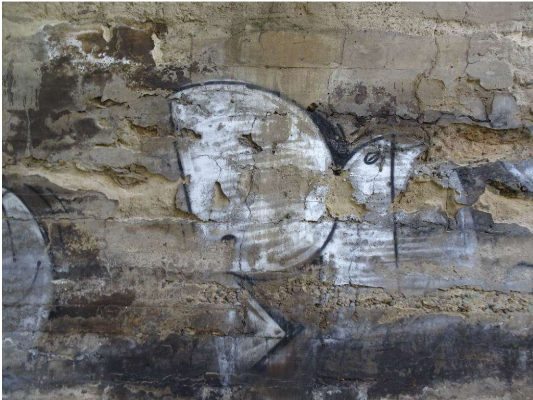
Rys. 1. Przyciótek południowo-wschodni. Ubytki betonu
