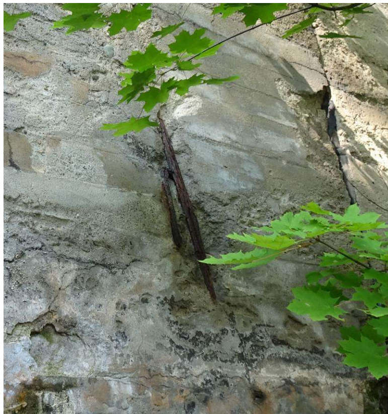
Rys. 1. Korozja zbrojenia przyczółku
