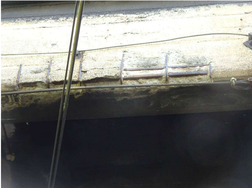
Rys. 1. Korozja zbrojenia dźwigara głównego. Uszkodzenia otuliny betonowej
