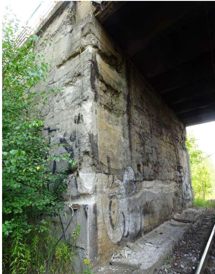
Rys. 1. Przyciótek północno-zachodni. Ubytki betonu
