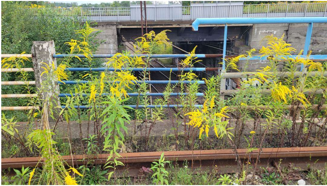
Rys. 1. Korozja bariery przy torowisku tramwajowym
