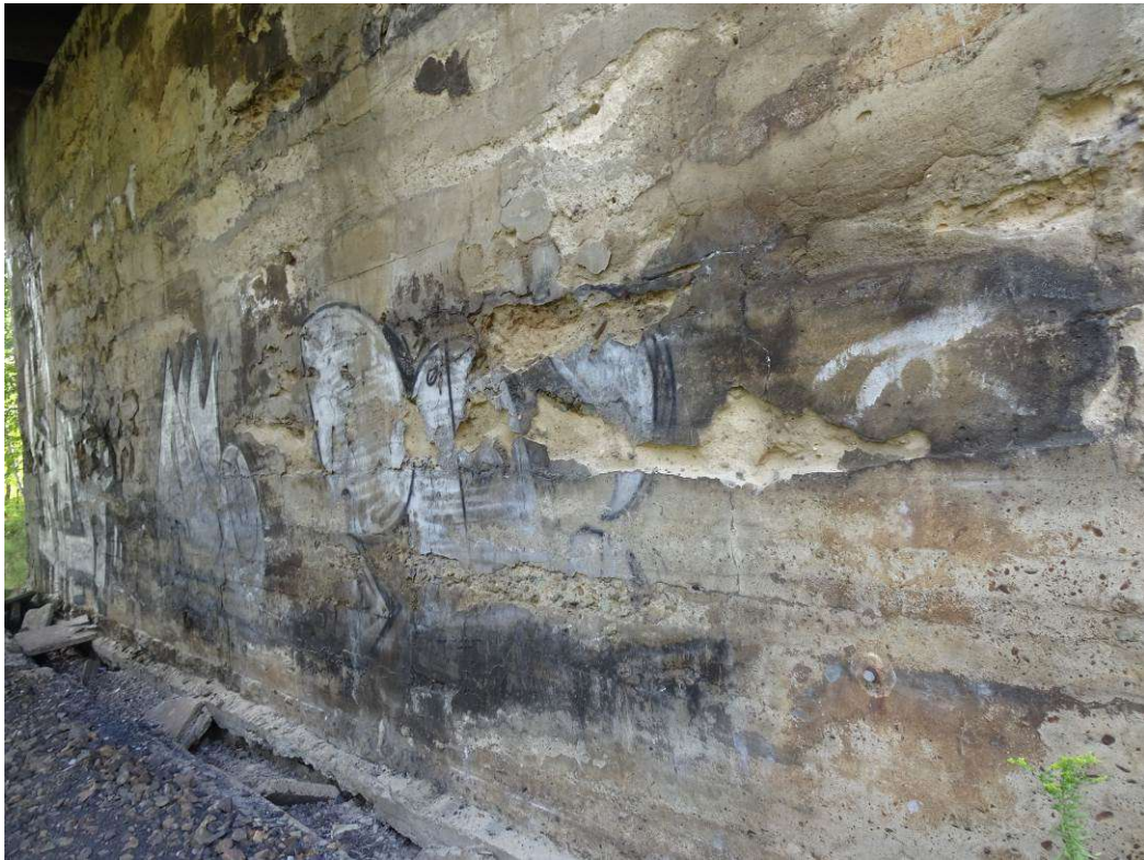
Rys. 1. Przyciótek południowo-wschodni. Ubytki betonu
