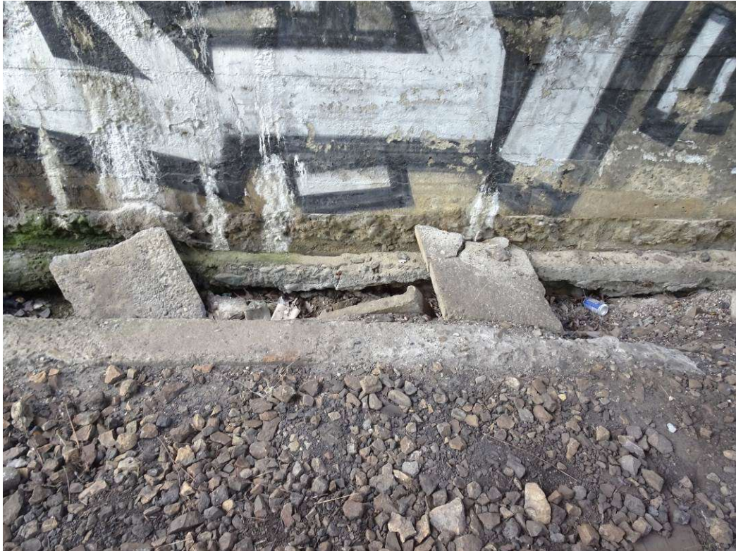
Rys. 1. Uszkodzenia kanałów przy przyczółkach
