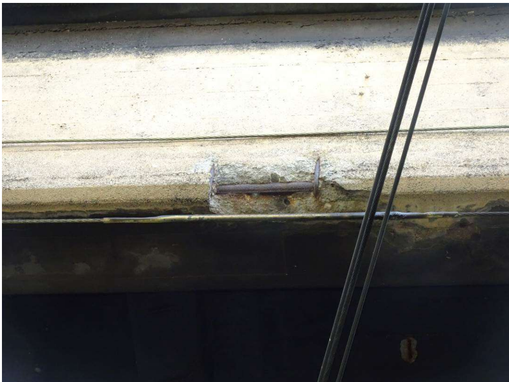
Rys. 1. Korozja zbrojenia dźwigara głównego. Uszkodzenia otuliny betonowej
