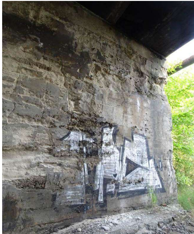
Rys. 1. Przyciótek północno-zachodni. Ubytki betonu
