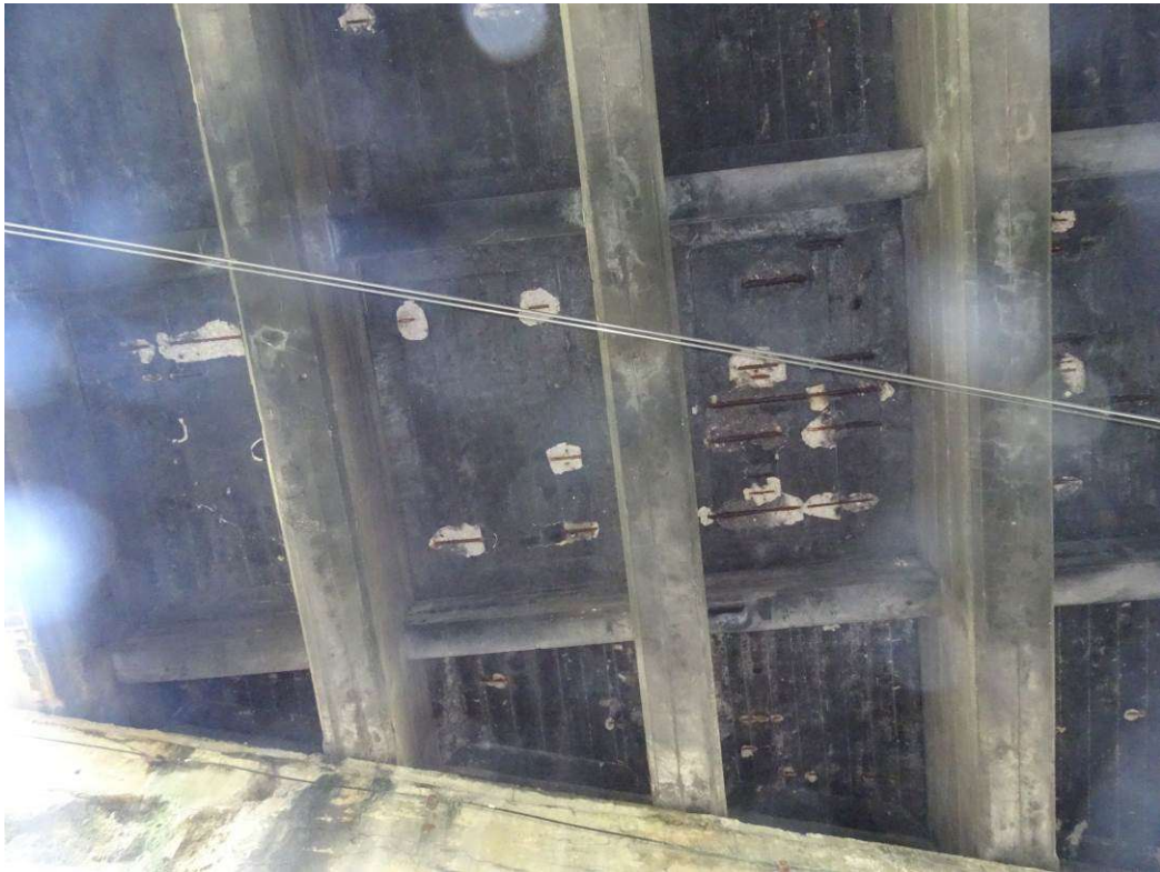
Rys. 1. Korozja zbrojenia płyty. Uszkodzenia otuliny betonowej
