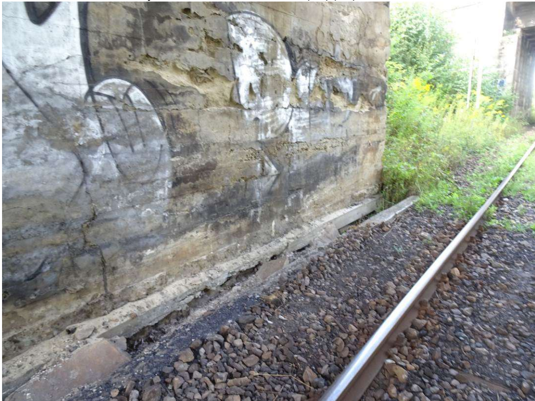
Rys. 1. Uszkodzenia kanałów przy przyczółkach
