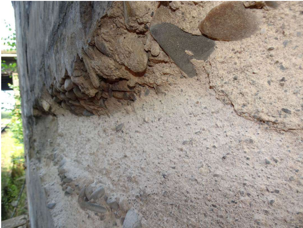
Rys. 1. Przyciótek północno-zachodni. Ubytki betonu
