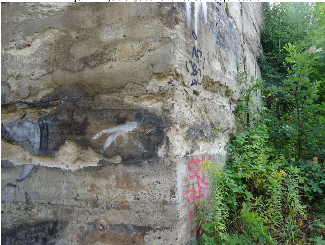
Rys. 1. Przyciótek południowo-wschodni. Ubytki betonu
