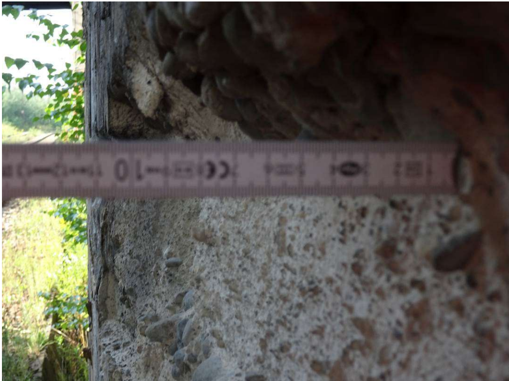
Rys. 1. Przyciótek północno-zachodni. Ubytki betonu
