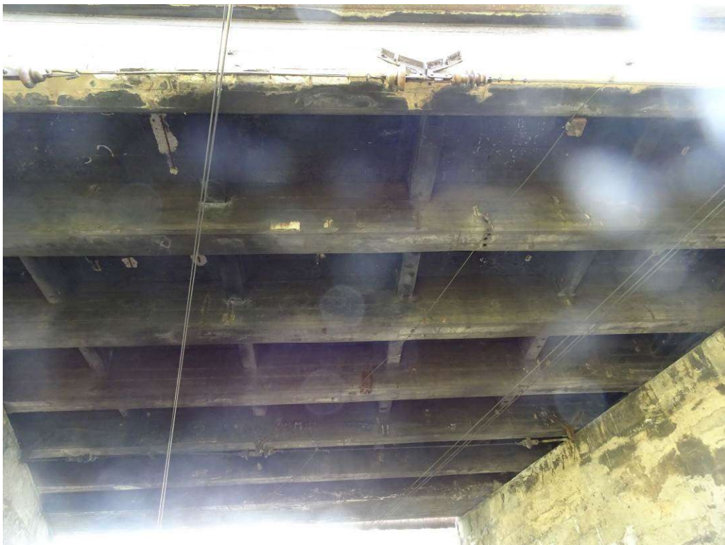
Rys. 1. Korozja zbrojenia dźwigara głównego i płyty. Uszkodzenia otuliny betonowej
