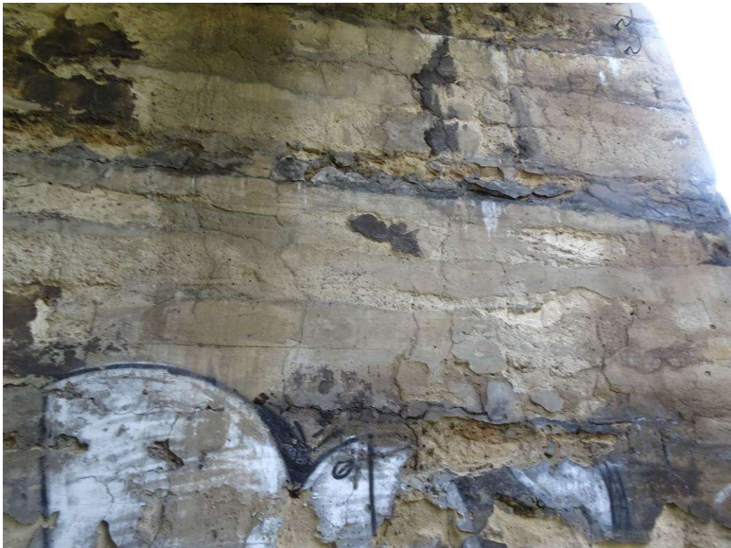
Rys. 1. Przyciótek południowo-wschodni. Ubytki betonu
