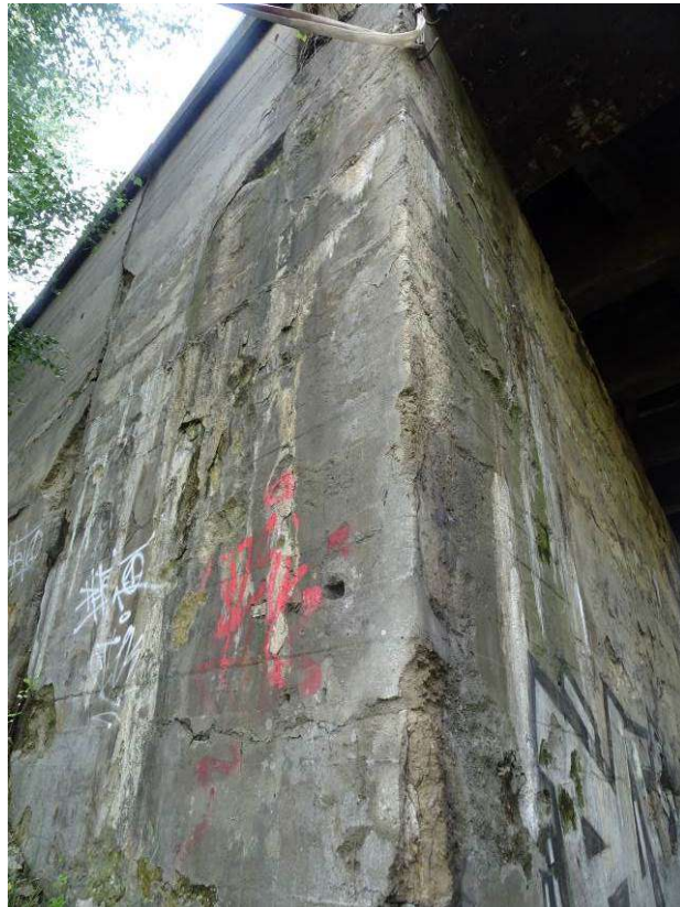
Rys. 1. Przyciótek południowo-wschodni. Ubytki betonu
