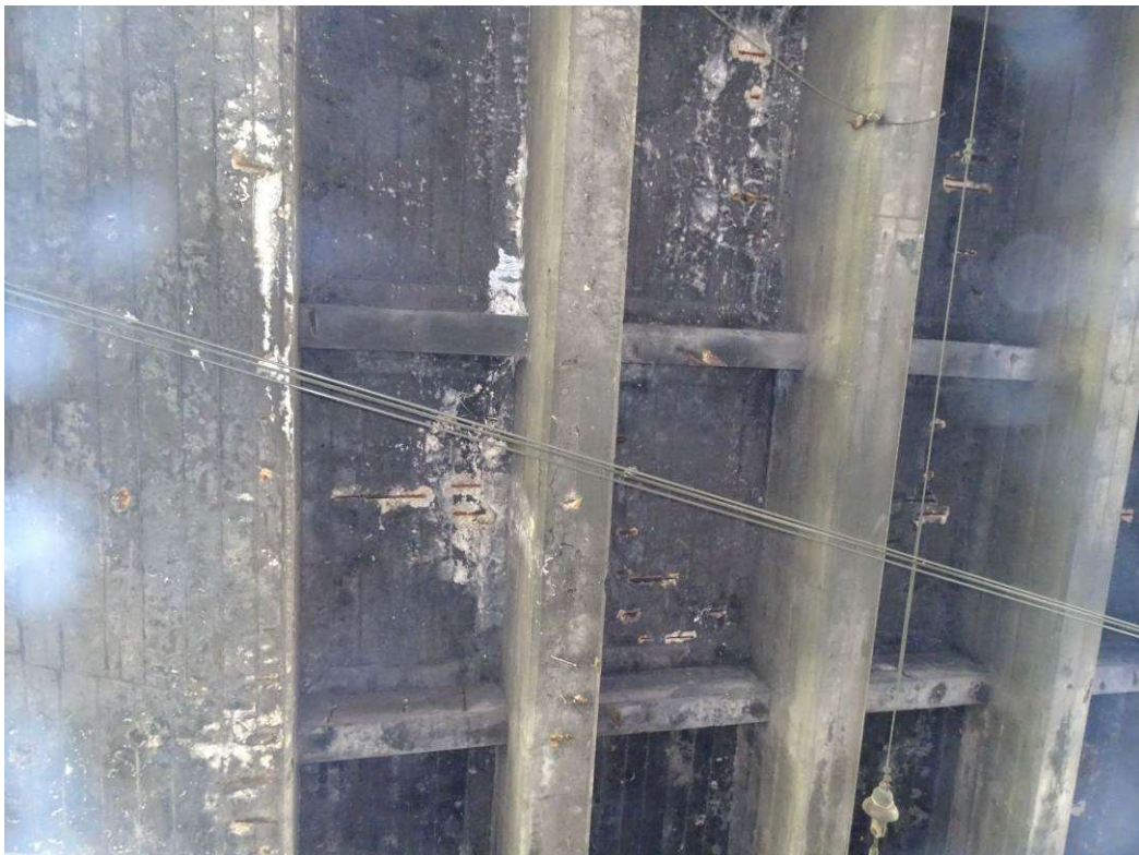
Rys. 1. Korozja zbrojenia płyty. Uszkodzenia otuliny betonowej
