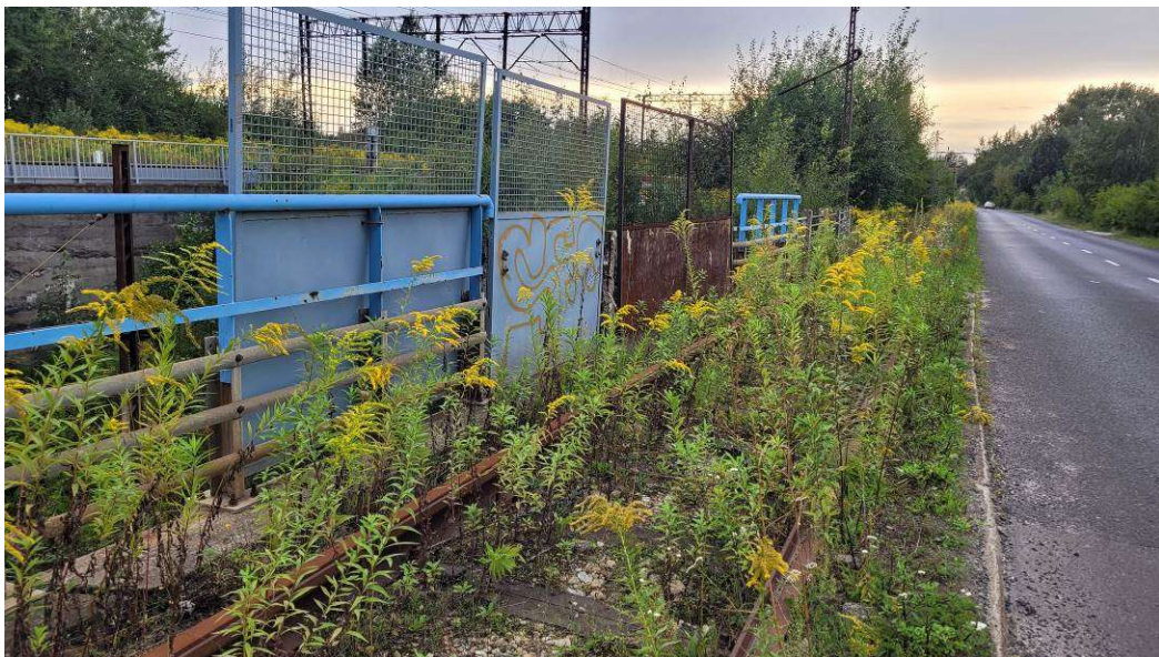
Rys. 1. Korozja bariery przy torowisku tramwajowym
