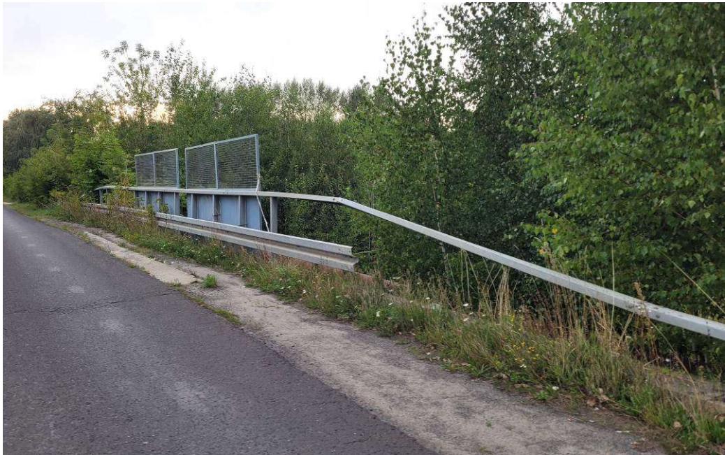
Rys. 1. Ubytki bariery ochronnej
