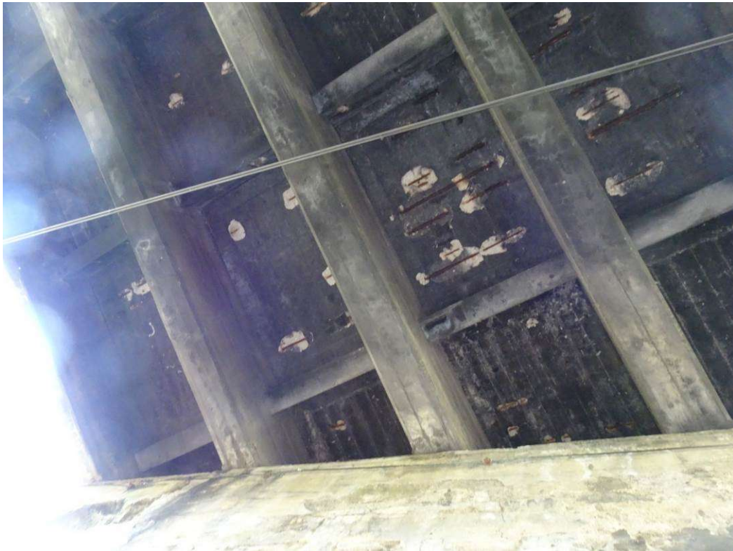
Rys. 1. Korozja zbrojenia płyty. Uszkodzenia otuliny betonowej
