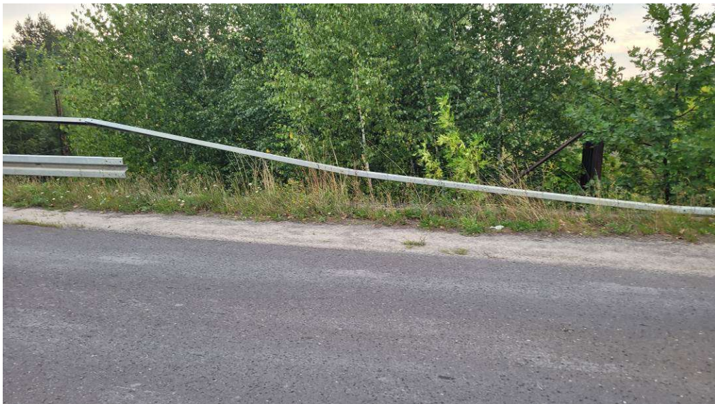
Rys. 1. Ubytki bariery ochronnej
