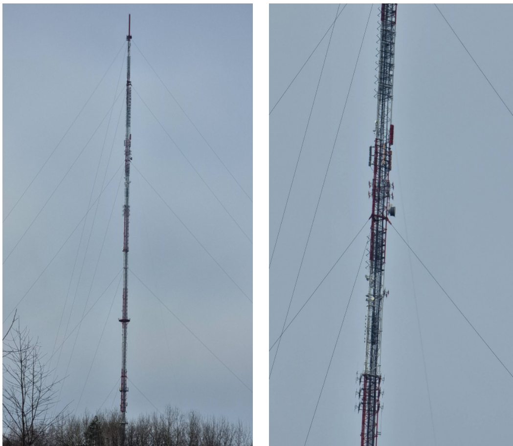
Widok obiektu wraz z zainstalowanym zespołem antenowym
